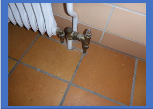
Bild 7: Rör genomföringar i golv.
