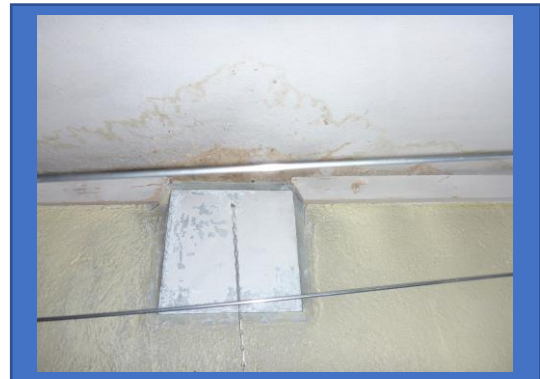
Bild 8: Missfärgning vid ventil, tvättstuga.
