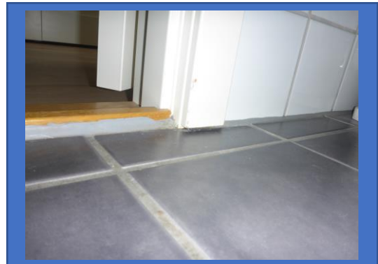
Bild 10: Avsaknad av våtrumströskel.
