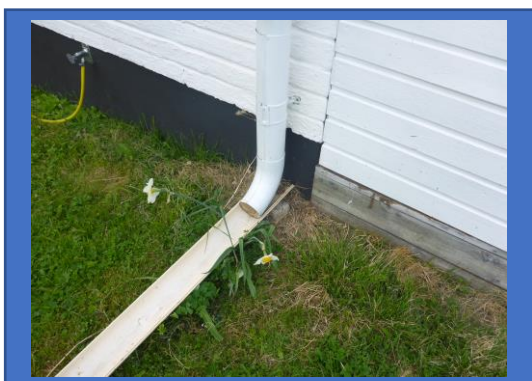
Bild 5: Stuprör ej markanslutna.
