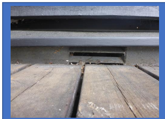
Bild 4: Lågt monterad ventil.
