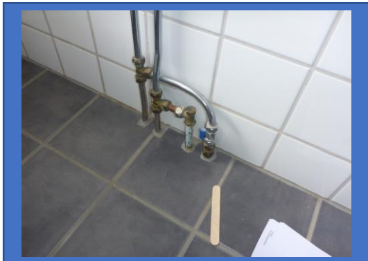
Bild 9: Rörgenomföringar i golv.
