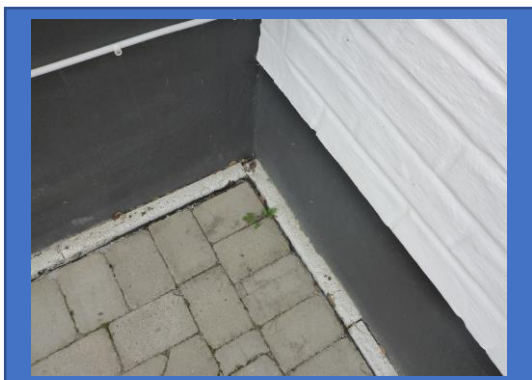
Bild 3: Överkantslist på markisolering saknas.
